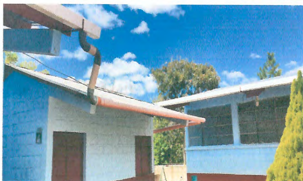
Foto 1: Reparación de canales estan en mal estado
